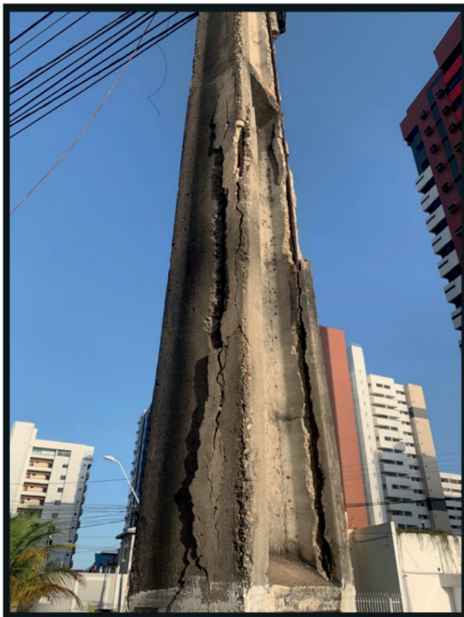
Figura 54 – Poste em situação de armadura exposta.
