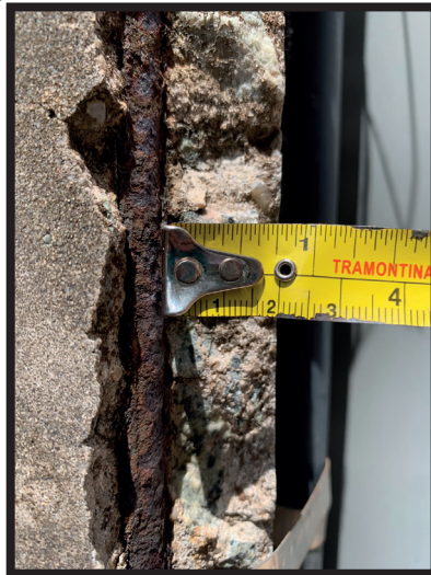
Figura 57 – Cobrimento mínimo insuficiente.
