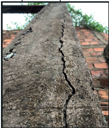
Figura 5 – Exemplo de Trinca paralela à armadura em pilar.
