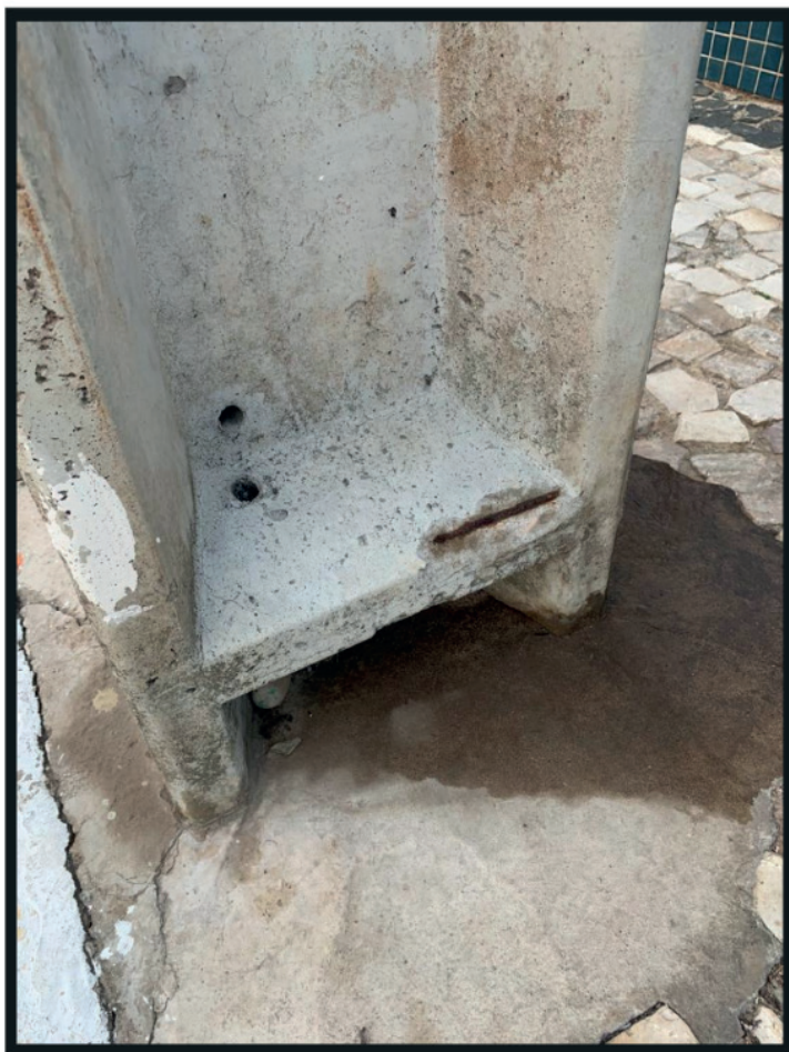
Figura 53 - Corrosão na parte inferior do poste.
