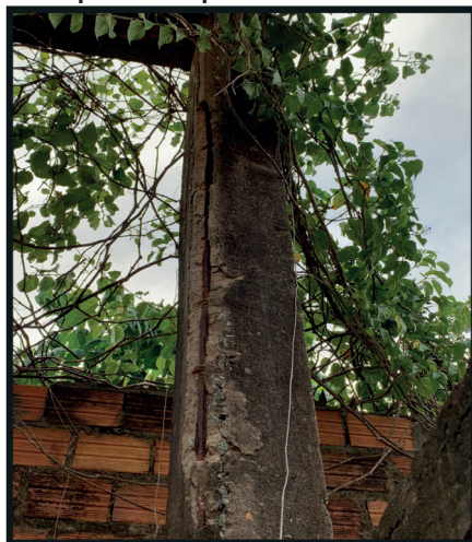
Figura 6 – Exemplo de deslocamento da armadura em pilar.
