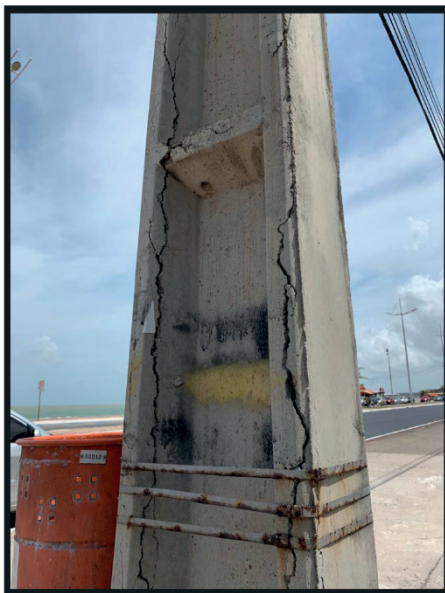
Figura 55 – Poste apresentando trincas elevadas.
