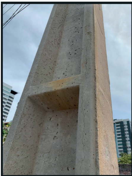
Figura 56 – Poste apresentando Fissuras.
